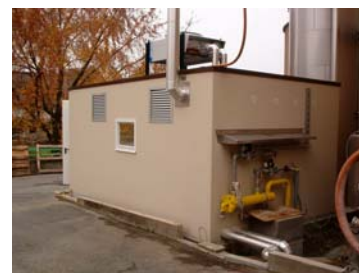
Local technique aménagé avec tuyauteries gaz et chaleur, accumulateur et refroidissement.
